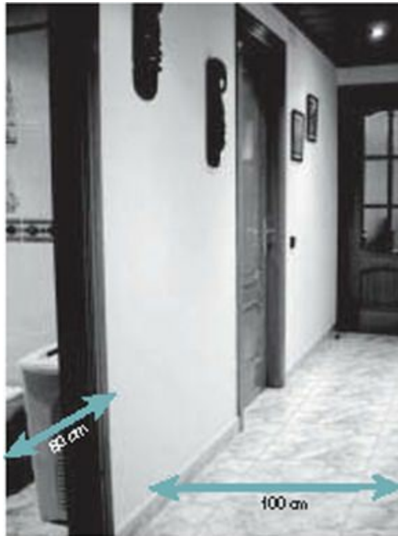
Figura 24-6 Espacio de giro insuficiente.
